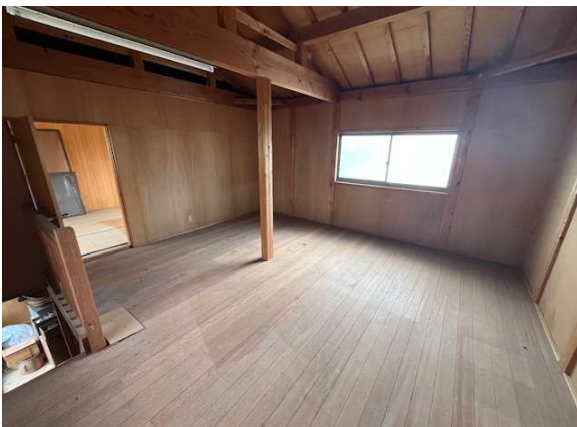
( 農業用倉庫 2階 )
