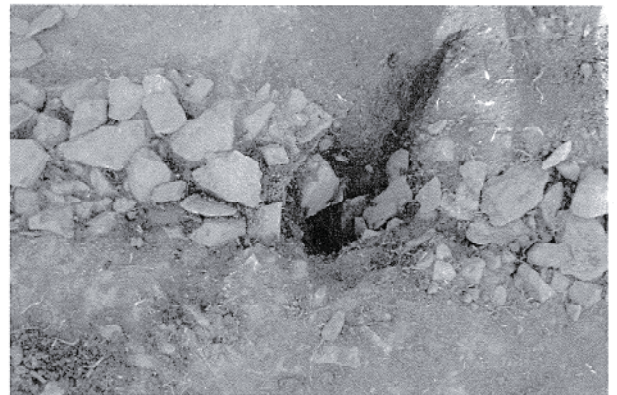
写真7 暗渠排水溝を引き裂く地割れ(上から撮影)
